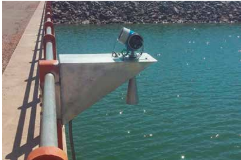
Sensado por radar de nivel de embalse
