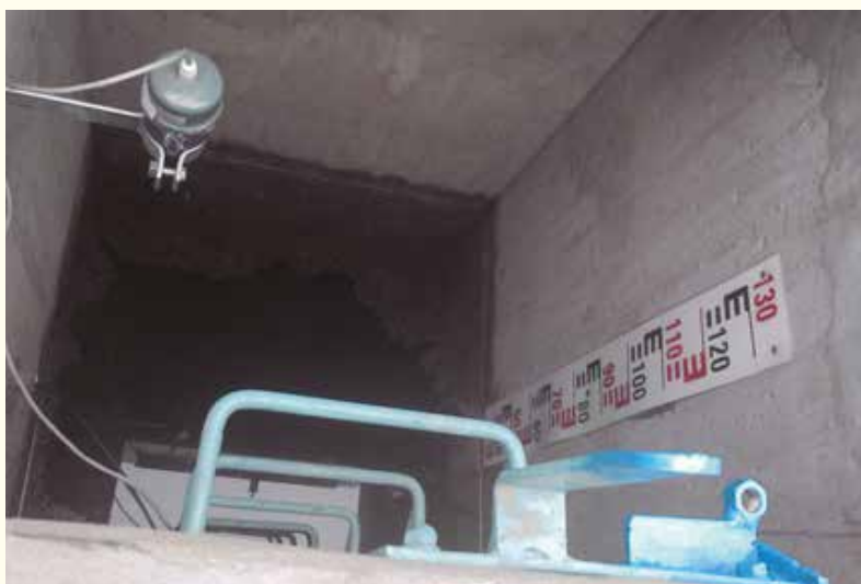
Aforador típico (exterior e interior)
