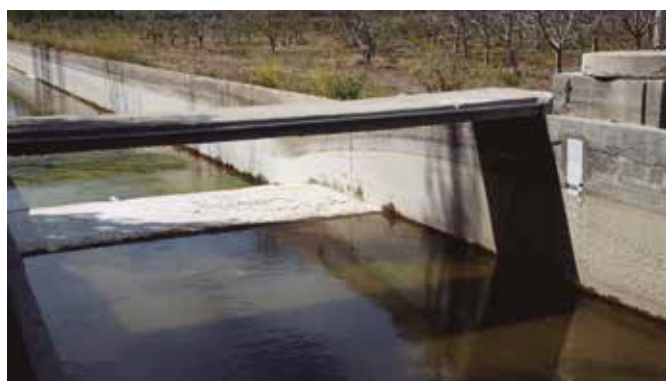
Secciones de aforo para medición de caudales por el método de altura piezométrica
